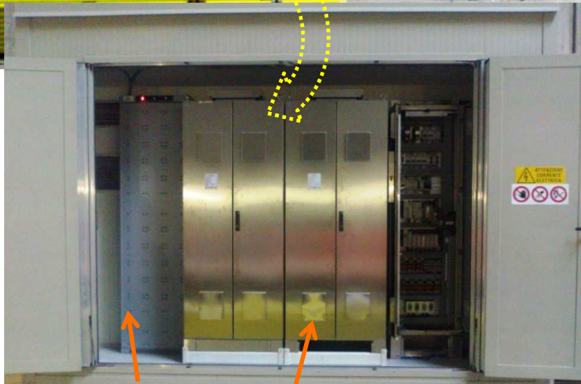
ADM – quadro alimentazione 1000V
